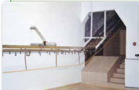
Départ du convoyeur du tunnel
